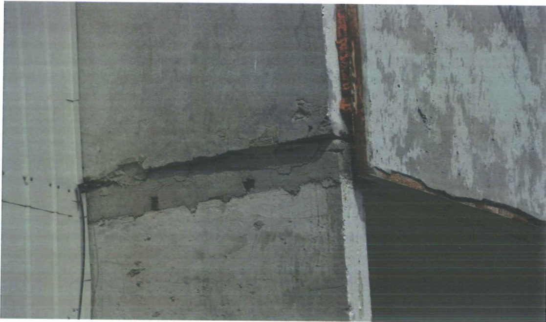
Fot.6. Ściana osłaniająca balkonu –widoczne naprawy na połączeniu płyt.
