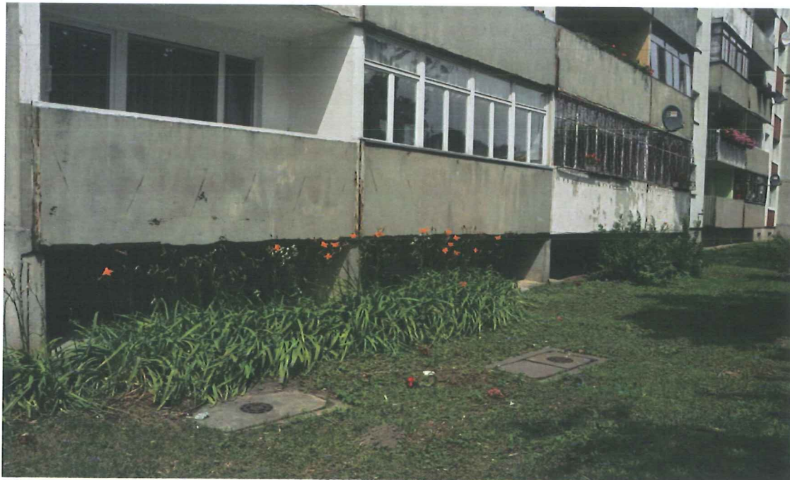
Fot.5. Widok loggii – skorodowane elementy metalowe, betonowa balustrada .
