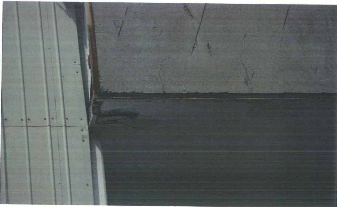
Fot.2. Widok na balustradę loggii – zły stan elementów metalowych, popękana, odspojona, zagrzybiona balustrada betonowa.
