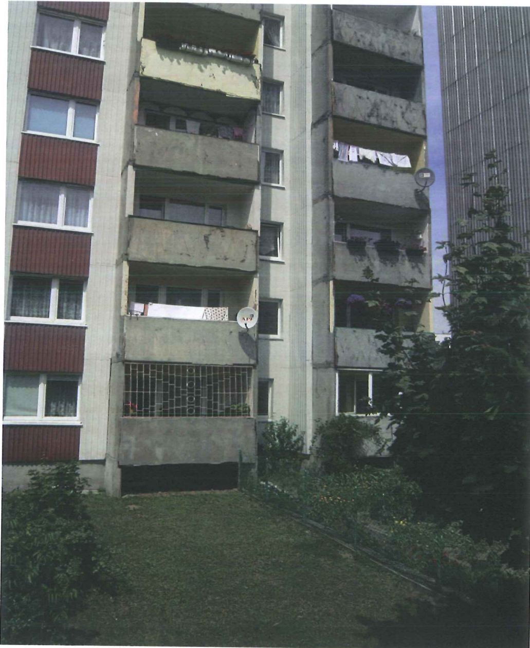
Fot.1. Widok na fragment elewacji z loggiami i balkonami- zły stan techniczny większości balustrad.
