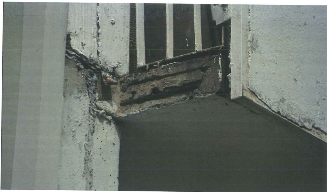
Fot.3. Detal płyty żelbetowej loggii – widoczna korozja elementów metalowych oraz płyty z widocznym zbrojeniem.
