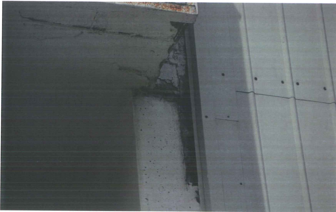
Fot.4. Widok płyty balkonu od spodu – ubytki w płycie, widoczne zbrojenie.
