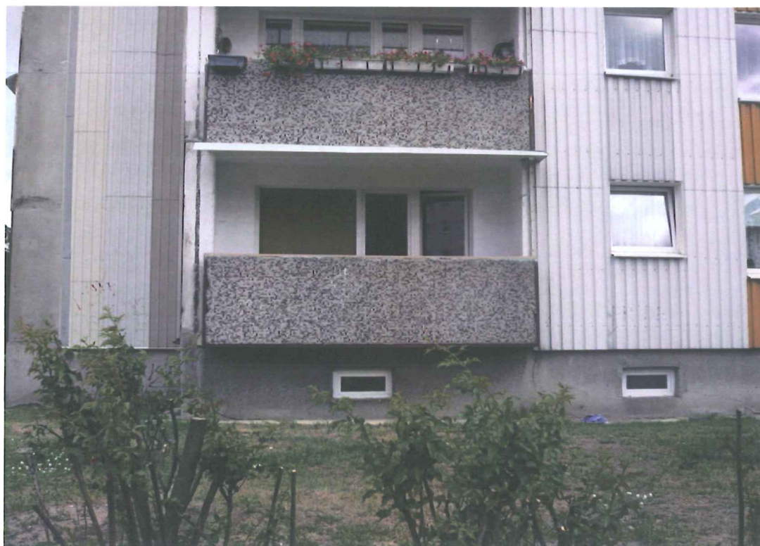
FOT.1.,2. Widoki na fragmenty elewacji z loggiami i balkonami- średni -zły stan techniczny
