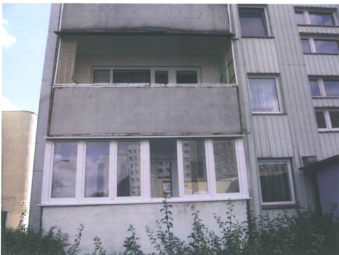
Fot.1.,2. Widoki na fragmenty elewacji z loggiami i balkonami- średni -zły stan techniczny
