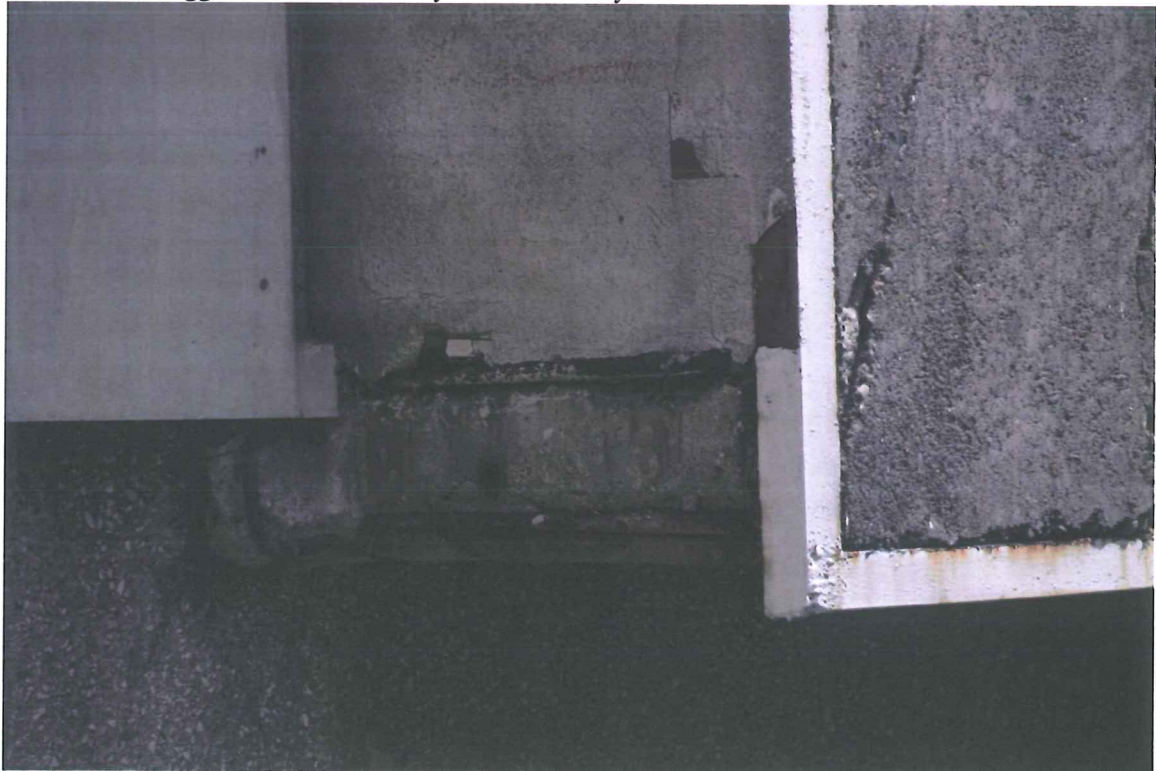
Fot.5. Detal loggii – widoczna korozja elementów metalowych oraz płyty z widocznym zbrojeniem.
