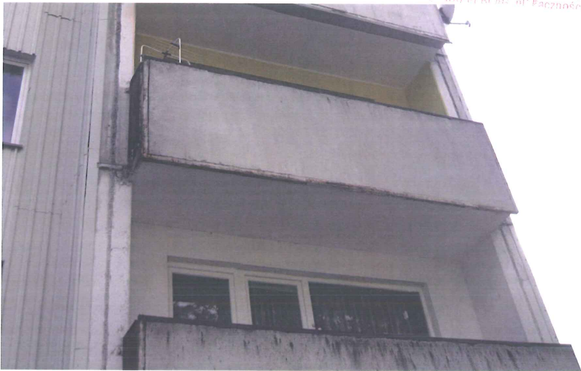
Fot.4. Widok loggii z balustradami- zły stan techniczny.
