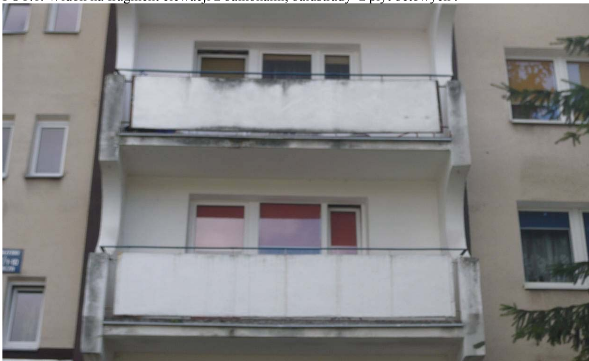
FOT.2. Widok na balkony. Płyta balkonowa oraz balustrady w średnim stanie technicznym. Brudne, zagłonięte.
