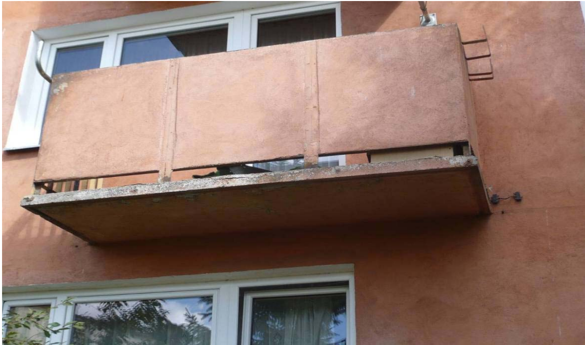
FOT.3. Widok na balkony. Płyta balkonowa w średnim, złym stanie technicznym. Balustrady w średnim stanie technicznym. Brudne, zagłonięte. Widoczne ubytki płyty.
