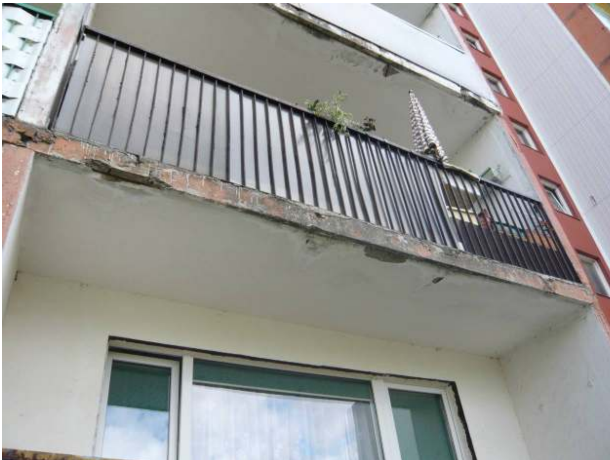
FOT.3. Widok na balkon. Płyta balkonu skorodowana , ubytki w warstwie konstrukcyjnej.
