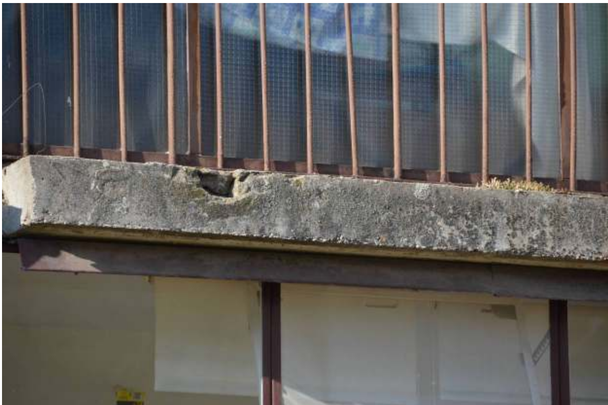
FOT.3. Widok na balkon. Płyta balkonu skorodowana , ubytki w warstwie konstrukcyjnej.
