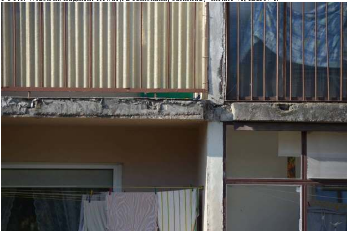
FOT.2. Widok na balkon. Płyta balkonu skorodowana, ubytki w warstwie konstrukcyjnej.
