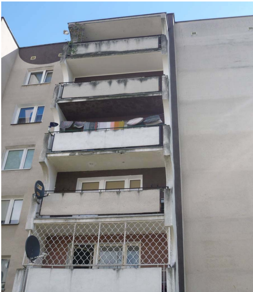
FOT.3. Widok na balkony. Płyta balkonu oraz balustrady w średnim stanie technicznym. Płyty zagłonięte, brudne.
