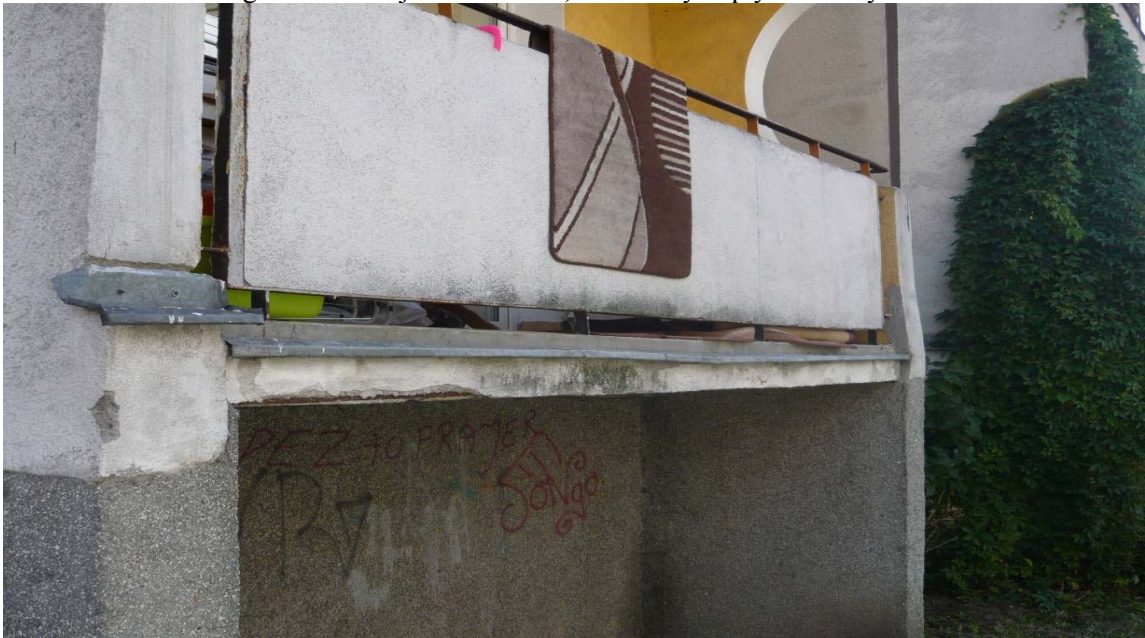
FOT.2. Widok na balkon. Płyta balkonu oraz balustrady w średnim stanie technicznym. Widać ubytki w płycie, fragment zbrojenia.
