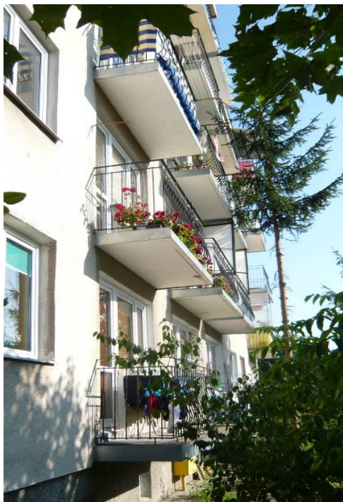
FOT.2. Widok na balkony. Płyta balkonu oraz balustrady w dość dobrym stanie technicznym.
