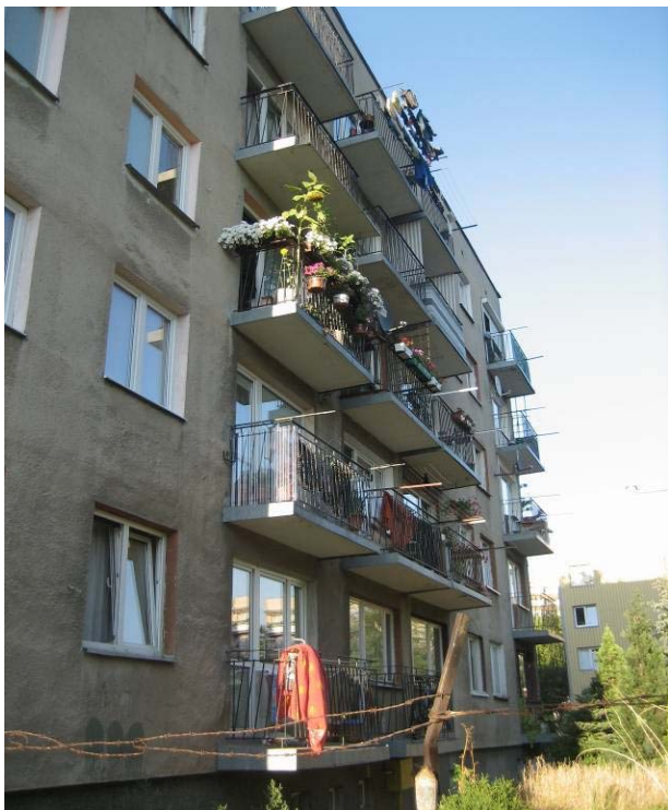
FOT.2. Widok na balkony. Płyta balkonu oraz balustrady w dość dobrym stanie technicznym.
