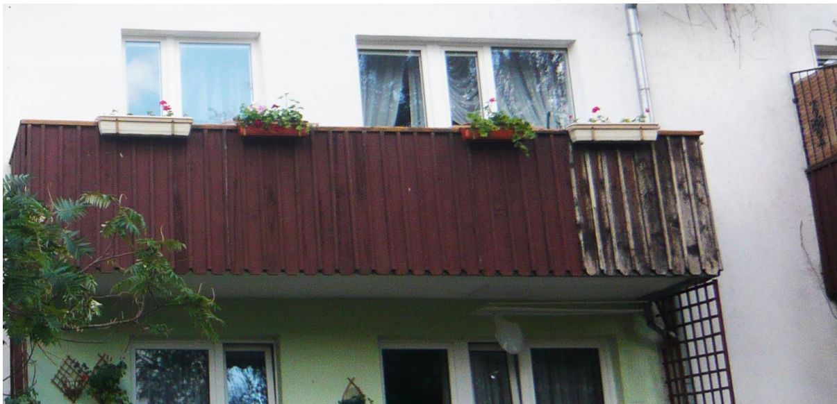
Fot.9. Zły stan techniczny balustrad balkonów.
