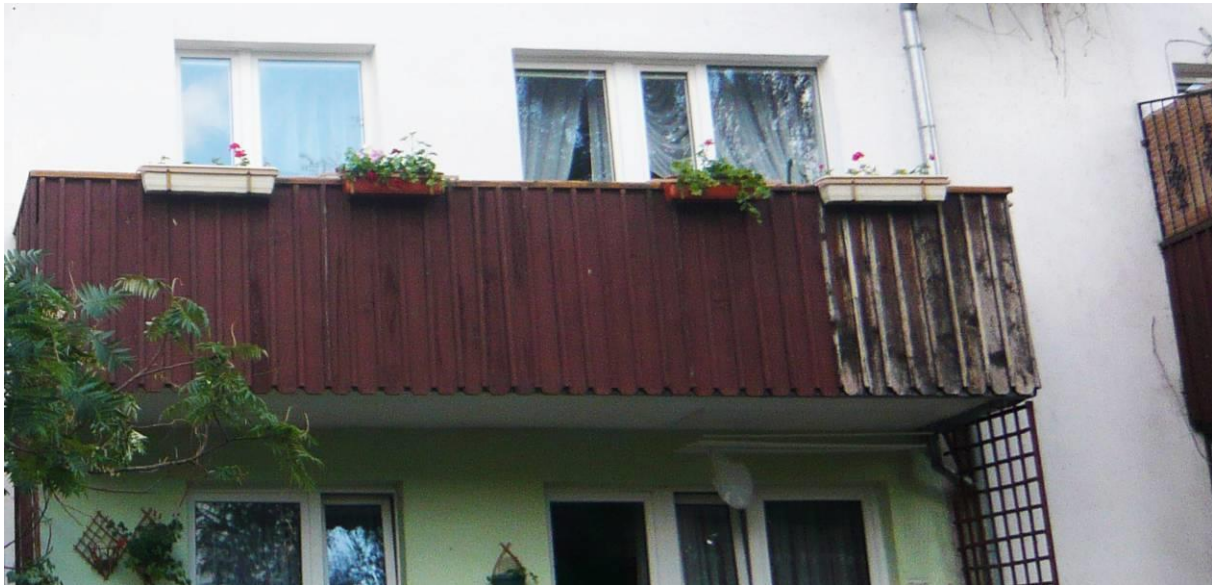
Fot.5. Widok na balkony - zły stan techniczny balustrad balkonów.
