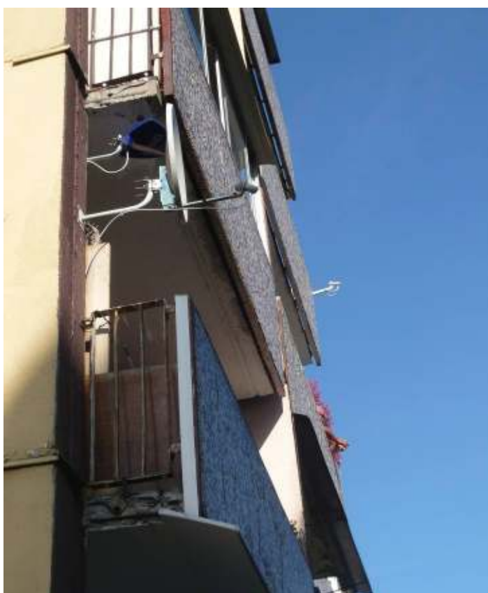
Fot.3.,4. Detale płyt balustrad loggii – widoczna korozja elementów metalowych oraz płyty z widocznym zbrojeniem, zły stan balustrady metalowej ażurowej.
