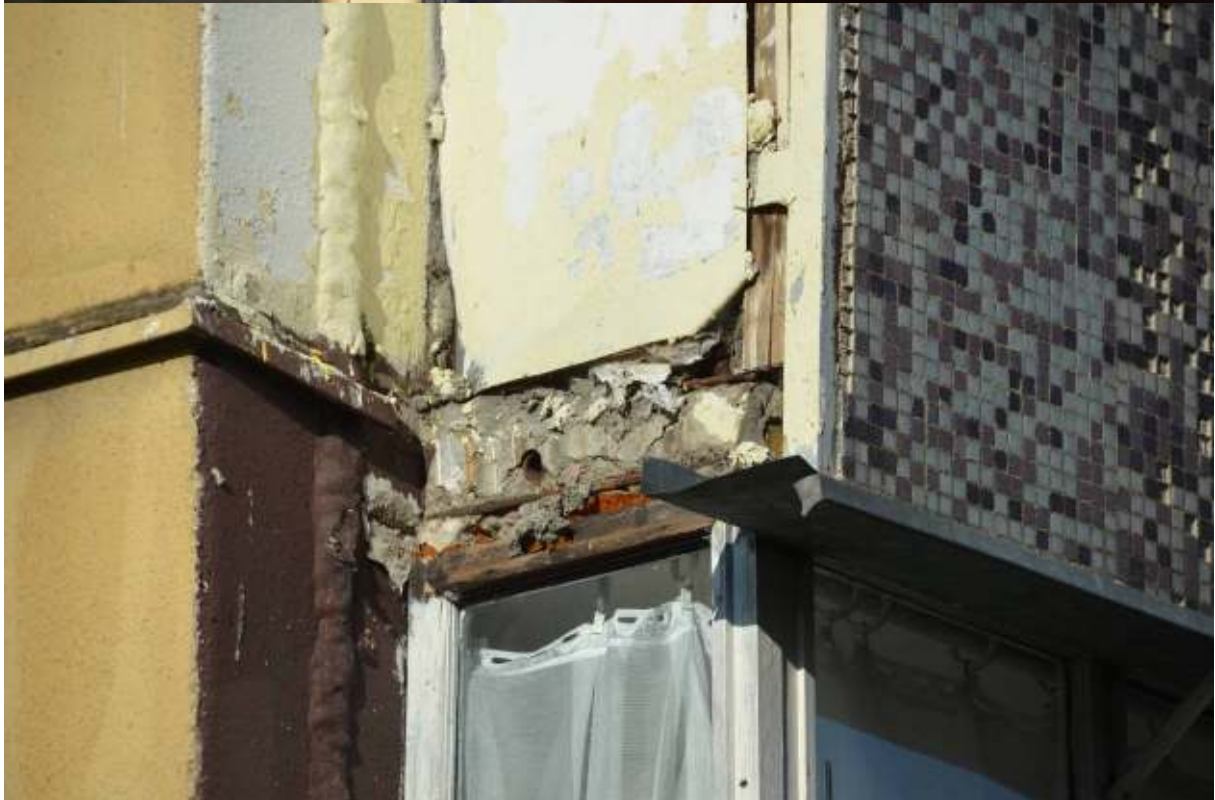
FOT.3.,4. Detale płyt balustrad loggii – widoczna korozja elementów metalowych oraz płyty z widocznym zbrojeniem, zły stan balustrady metalowej ażurowej, liczne spękania balustrady betonowej.
