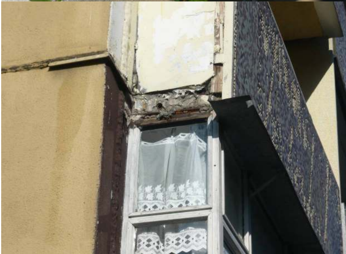
FOT.5.,6. Detale płyt balustrad loggii – widoczna korozja elementów metalowych oraz płyty z widocznym zbrojeniem, zły stan balustrady metalowej ażurowe, liczne spękania balustrady betonowej.
