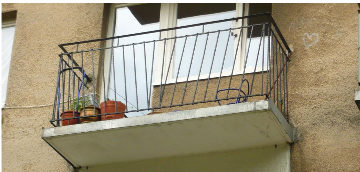
Fot 3. Płyta balkonu z barierką stalową mocowaną od góry
