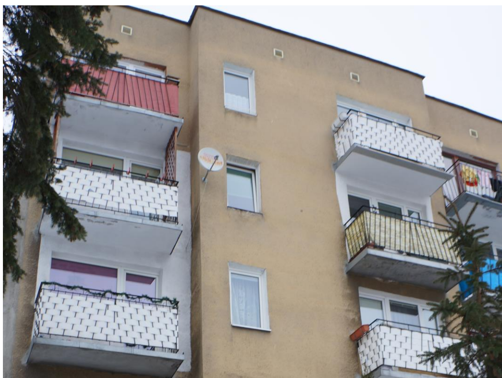
Fot. 2. Płyty balkonu z barierką stalową mocowaną od góry
