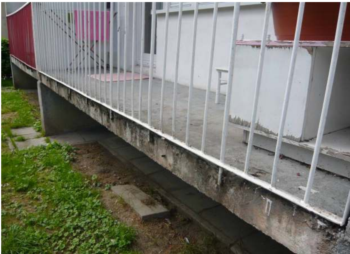
FOT.3. Detal płyt i balustrad balkonów – stan techniczny średni –dobry.
