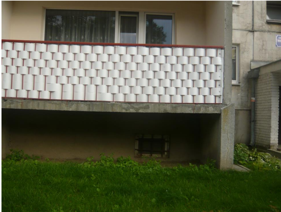
Fot. 3. Widok loggii od strony zachodniej- zły/średni stan techniczny
