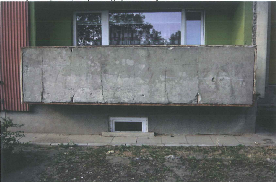
Fot.5. Widok płyty balkonu– ubytki w płycie, nieestetyczny wygląd.
