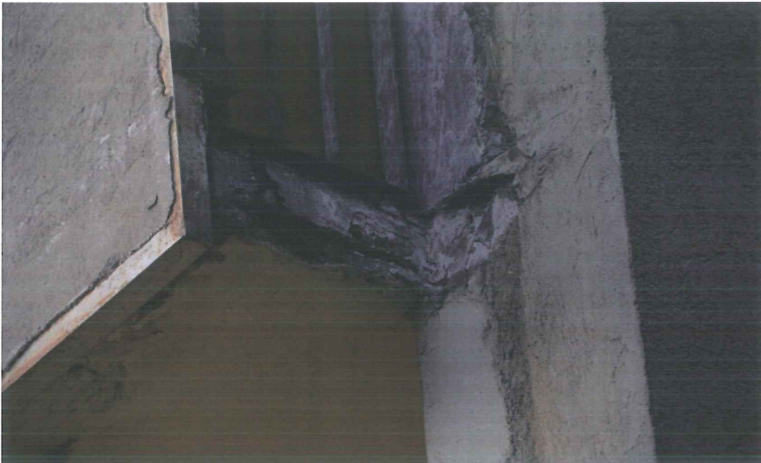
Fot.4. Detal płyty żelbetowej loggii – widoczna korozja elementów metalowych oraz płyty z widocznym zbrojeniem, od spodu zagrzybienie i ubytki.
